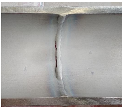
Obr. 4: Trhlina podél svarového úkosu
