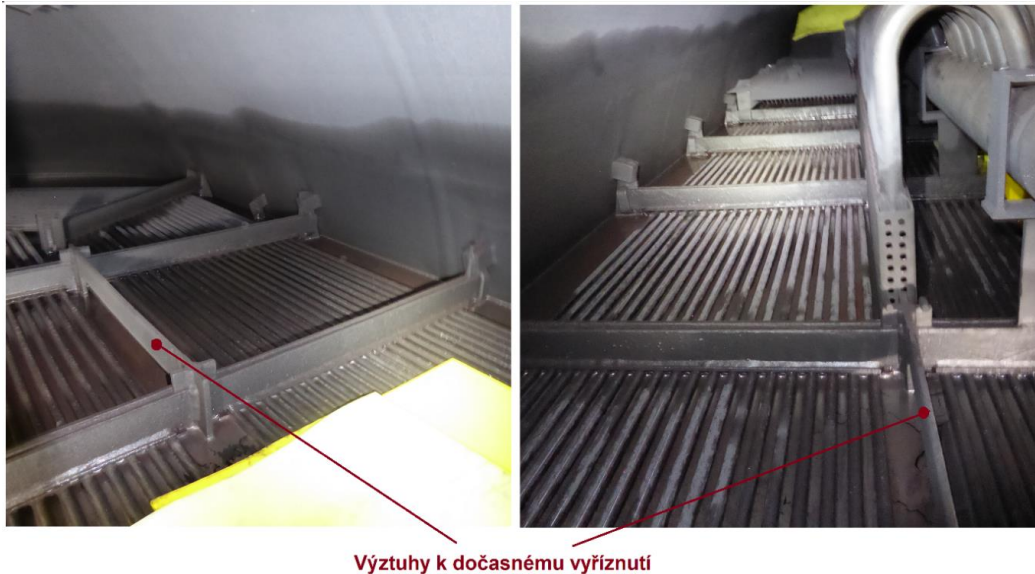
Obr. 2: Výztuha podpěrného systému v podélných sektorech teplosměnného svazku [3] Důvody tohoto rozhodnutí byly následující:
